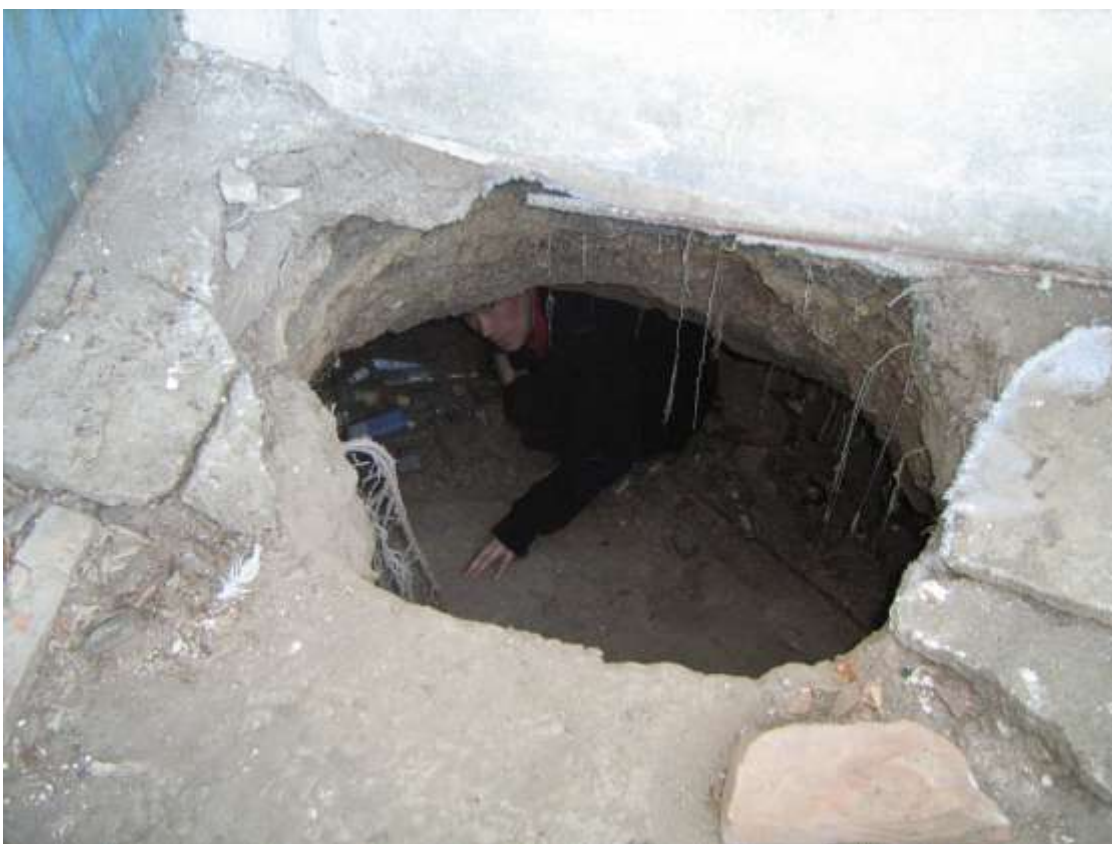
Провал под домом Нагайши Демешевой, пос.Березовка, январь 2011.
